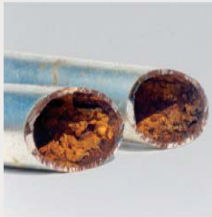
usazeniny v potrubí
